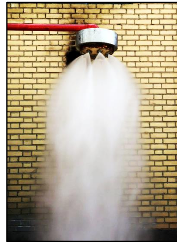
تست نازل اطفاء حریق مه پاش / واترمیست
